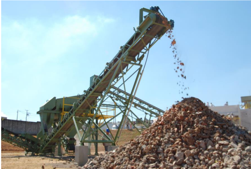
FIGURA 8: MÁQUINA DE TRITUTAR RESÍDUOS SÓLIDOS
