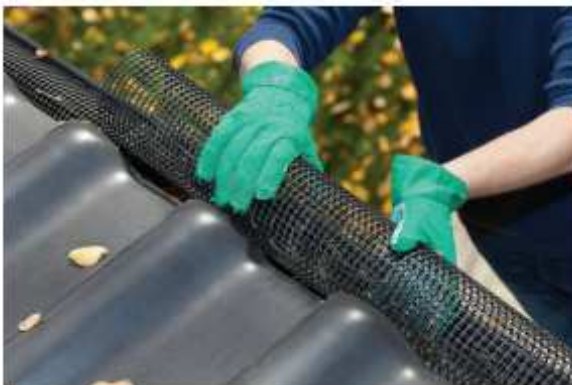
Figura 5 - Proteção de calhas para evitar acúmulo de detritos
