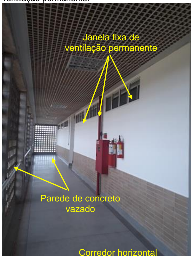
Figura 3-4 – Vista da parede entre corredor e salas de aula com destaque as janelas fixas de ventilação permanente.
