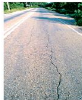
(b) Trincas longitudinais longas (TLL)
