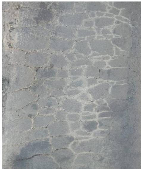
Figura 32 – Trincas interligadas -“Jacaré”
