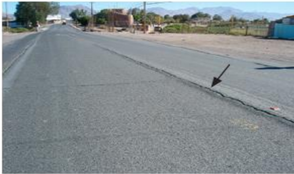
(c) Trinca de retração (TRR)
