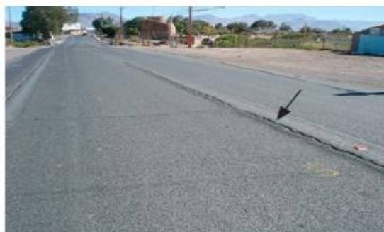
(c) Trinca de retração (TRR)
