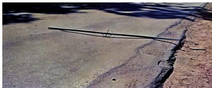
Figura 15 - afundamento de trilha de roda
