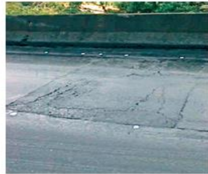
(d) Trinca de retração (TRR)
