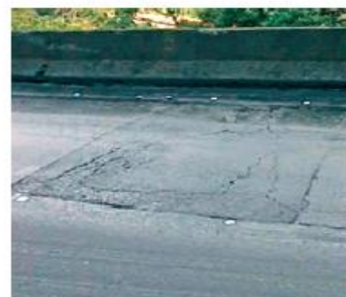
(d) Trinca de retração (TRR)
