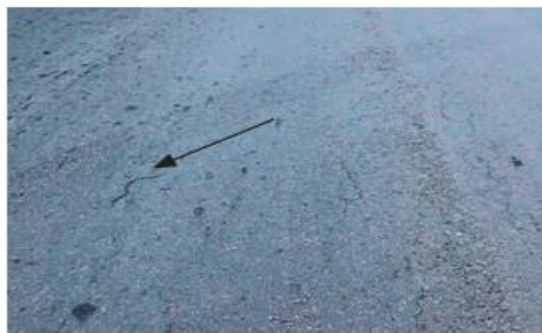
(a) Trincas isoladas curtas longitudinais (TLC)
