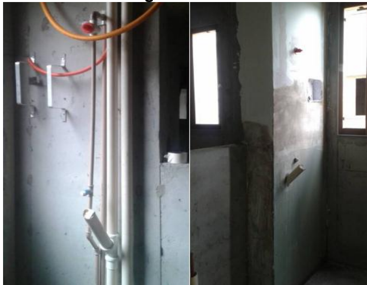
Instalação Hidráulica – Shaft
