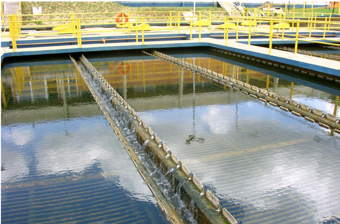
Figura 5. Decantador de Alta Taxa em funcionamento.
