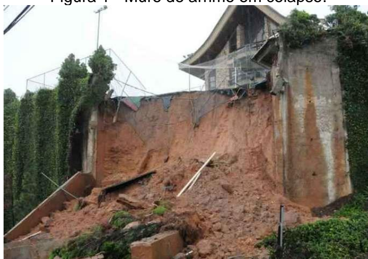
Figura 1 - Muro de arrimo em colapso.
